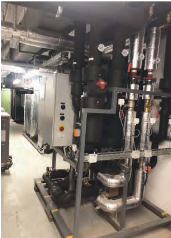
Hydraulische Bau- gruppe des Hochleistungs- kreislaufverbundsystems
