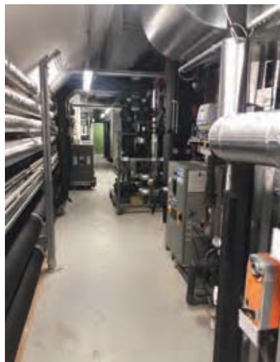
Technikzentrale für die Lüftungstechnik: Gang
